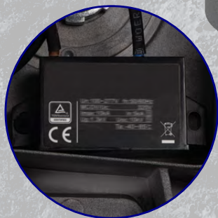
WBUDOWANE ZABEZPIECZENIE ANTYPRZEPŁCIOWE SPD 10KV
